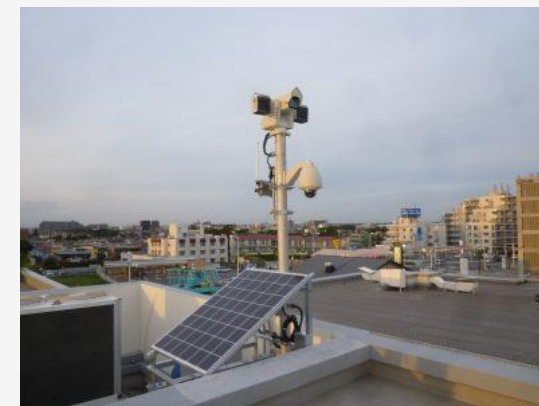
茅ヶ崎市 海面監視動画システム
